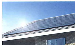
太陽光発電システム
